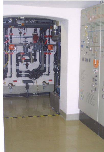
Abb.: Schaltraum zur Abklinganlage
