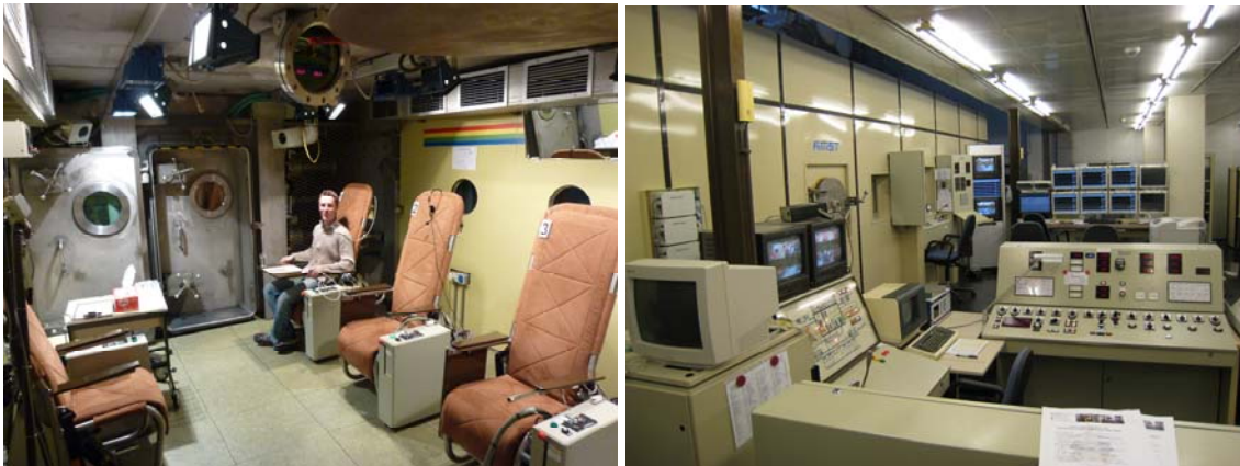
Abbildung 6 Blick in die Kammer (links) und Steuerung der HKS (rechts).
